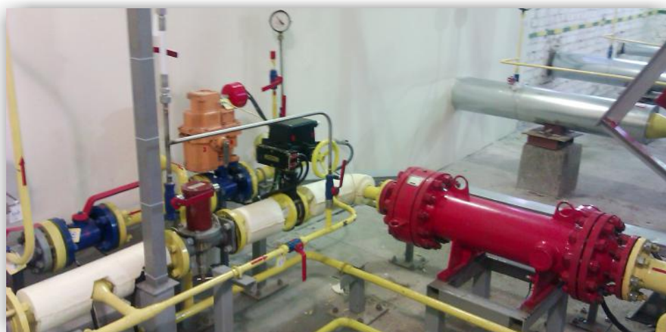
Установка МДГ-20 успешно работает на ГРС «Сертолово».
